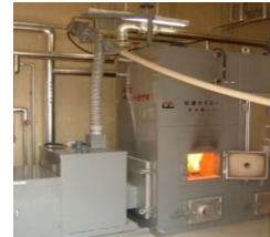
木質バイオマスボイラー
