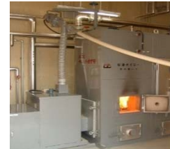
木質バイオマスボイラー
