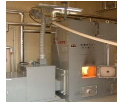
木質バイオマスボイラー
