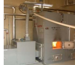
木質バイオマスボイラー
