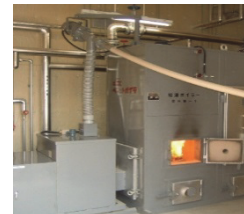
木質バイオマスボイラー
