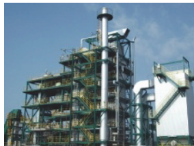
木質バイオマス発電所
